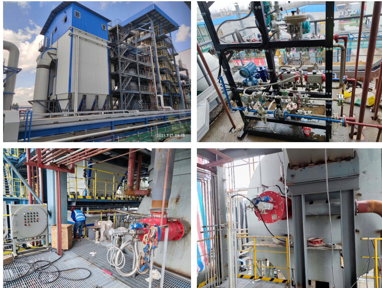
二燃室燃烧器
