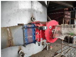
二燃室燃烧器
