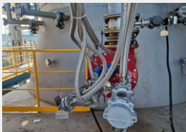
二燃室燃烧器
