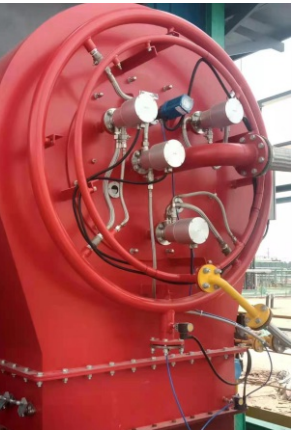
飞源化工80吨项目 Feiyuan Chemical 80 tons
