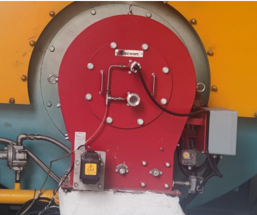
广东甘竹罐头有限公司6吨项目 Guangdong Ganzhu Canning Co., Ltd. 1 set of 6 tons project
