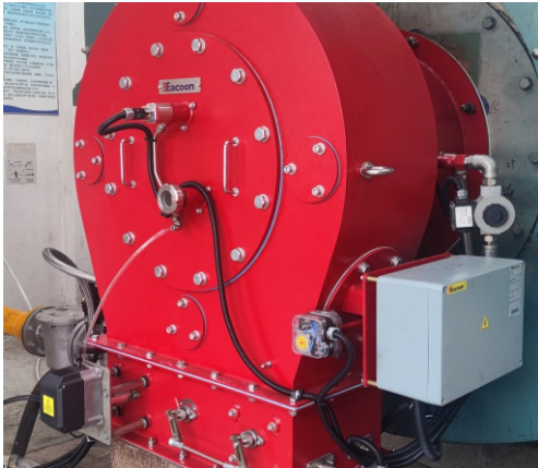
广东甘竹罐头有限公司8吨项目 Guangdong Ganzhu Canning Co., Ltd. 1 set of 8 tons project
