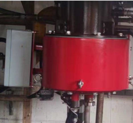
广东甘竹罐头有限公司2吨项目 Guangdong Ganzhu Canning Co., Ltd. 1 set of 2 tons project
