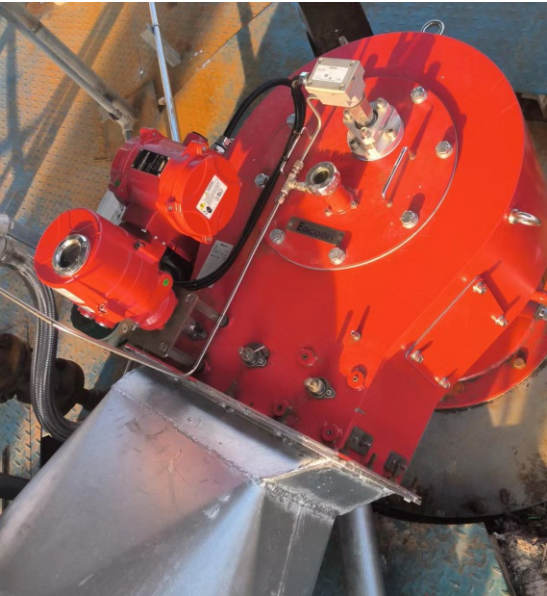
淄博胜炼化工6吨项目 Shenglian Chemical, Zibo, 6 tons project
