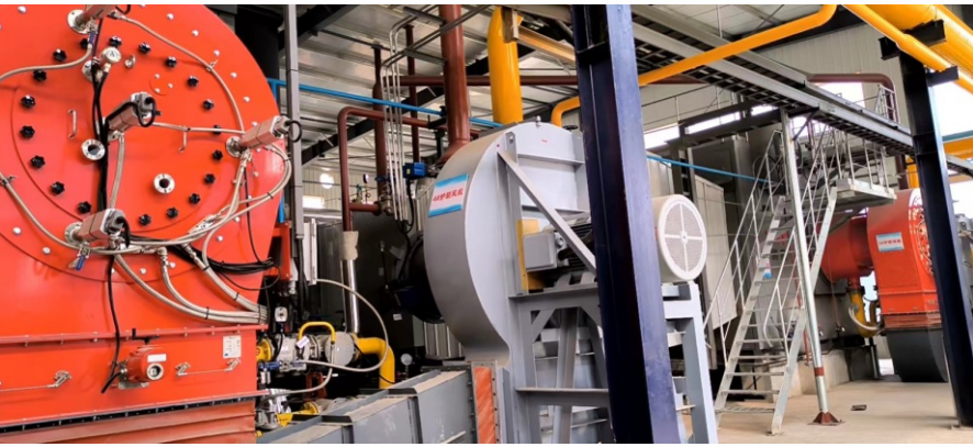
济矿民生热能两台50吨项目 Jikuang Minsheng Thermal Energy 2 sets of 50 tons
