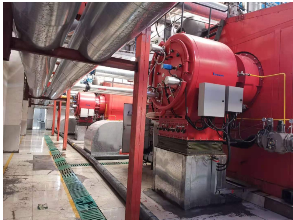
◀ 新疆乌鲁木齐天源 3台40吨超低氮燃烧器项目
