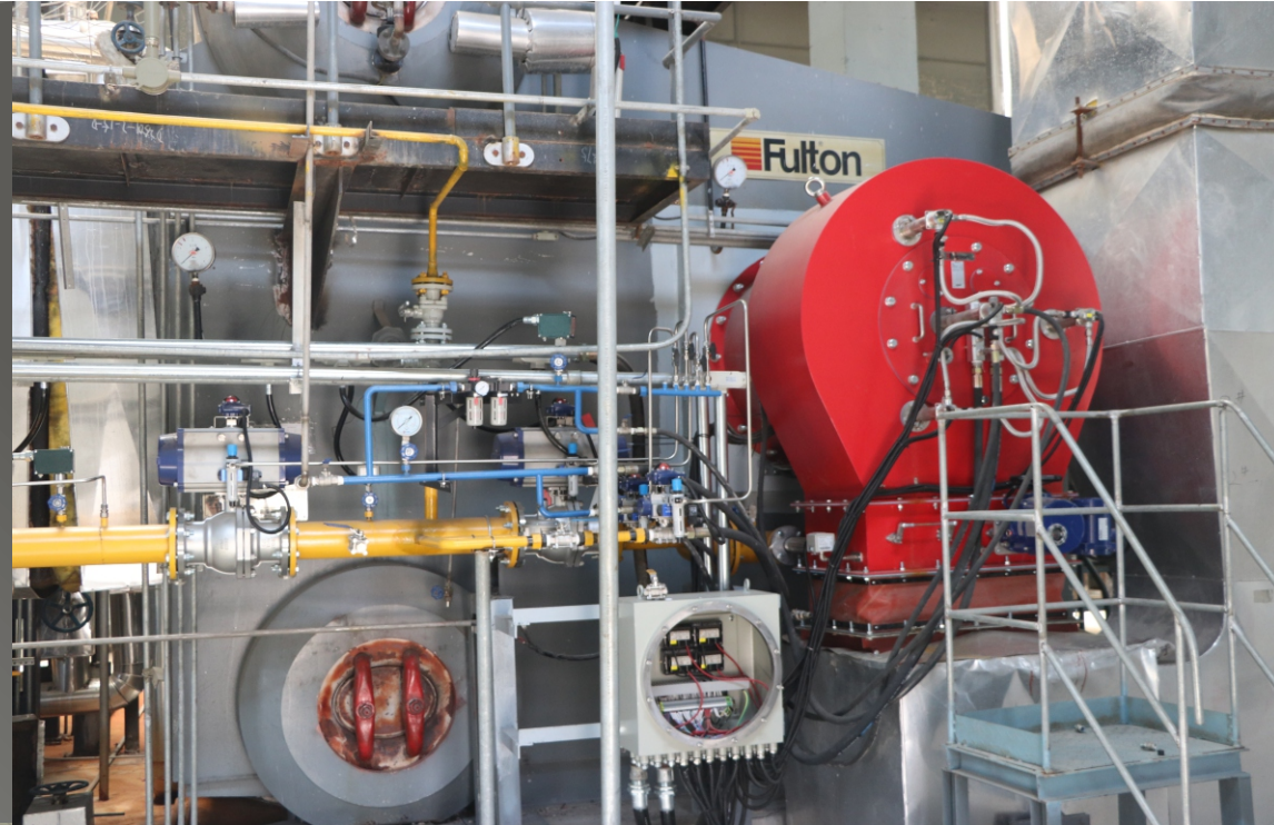
▲ 天津旻昊中安信科技 3台25吨超低氮燃烧器项目
