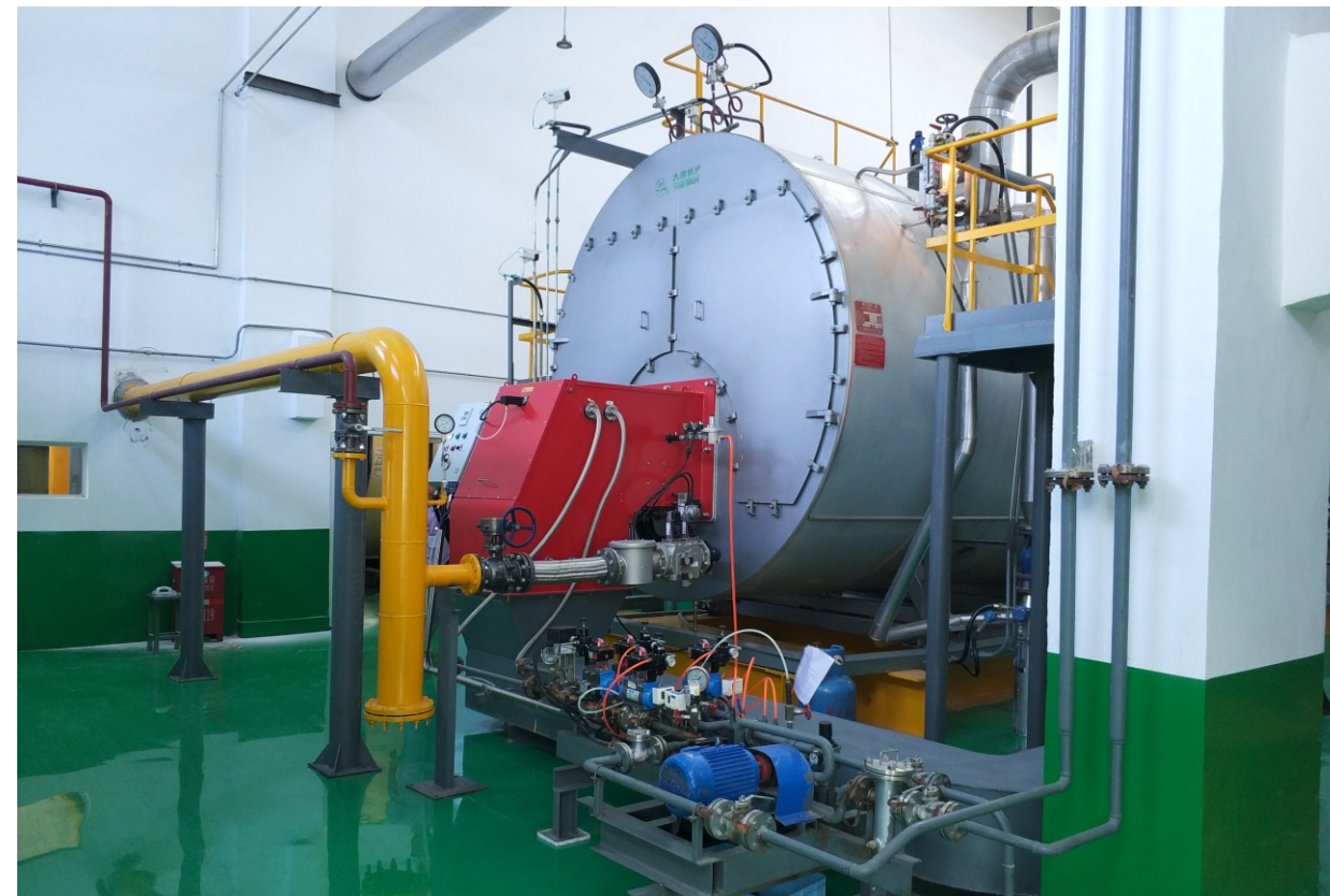
◀ 西安伊利泰普克饮品有限公司 20吨低氮油气两用燃烧器项目
