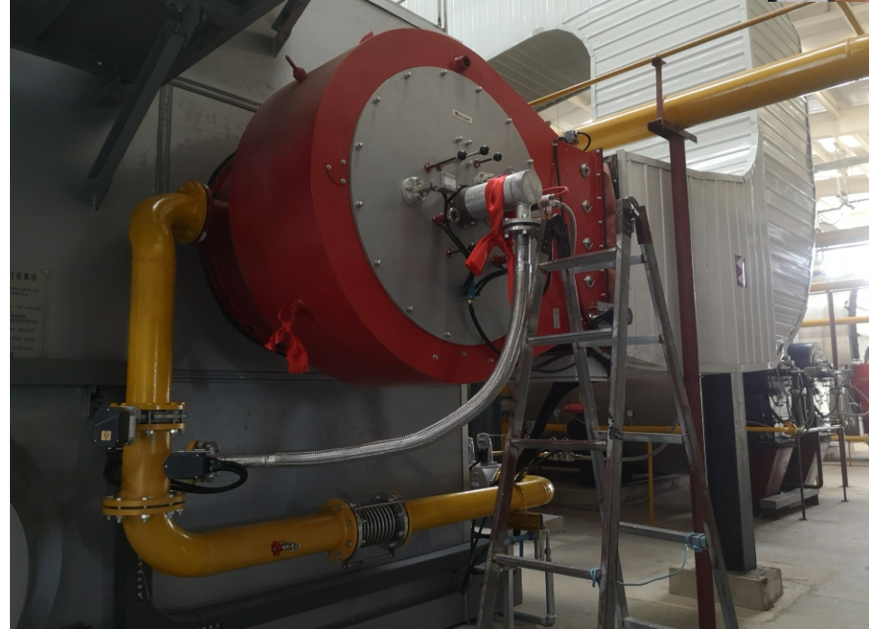
◀ 天津东丽湖 40吨超低氮燃烧器项目
