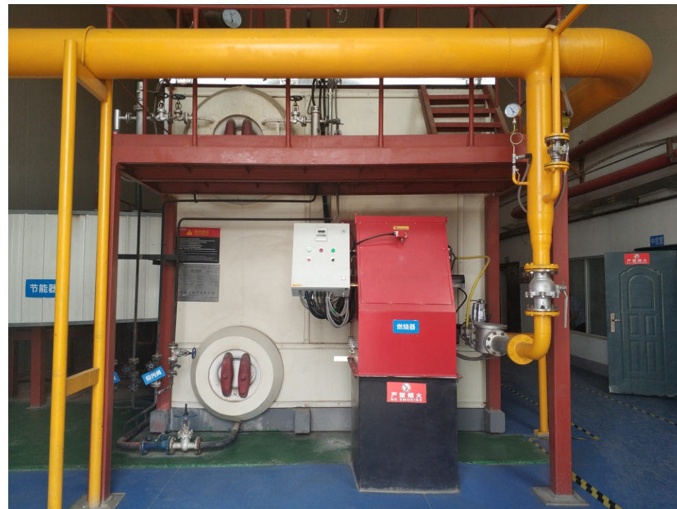
◀ 宁夏银川塞尚乳业 1台10吨超低氮油气两用燃烧器项目
