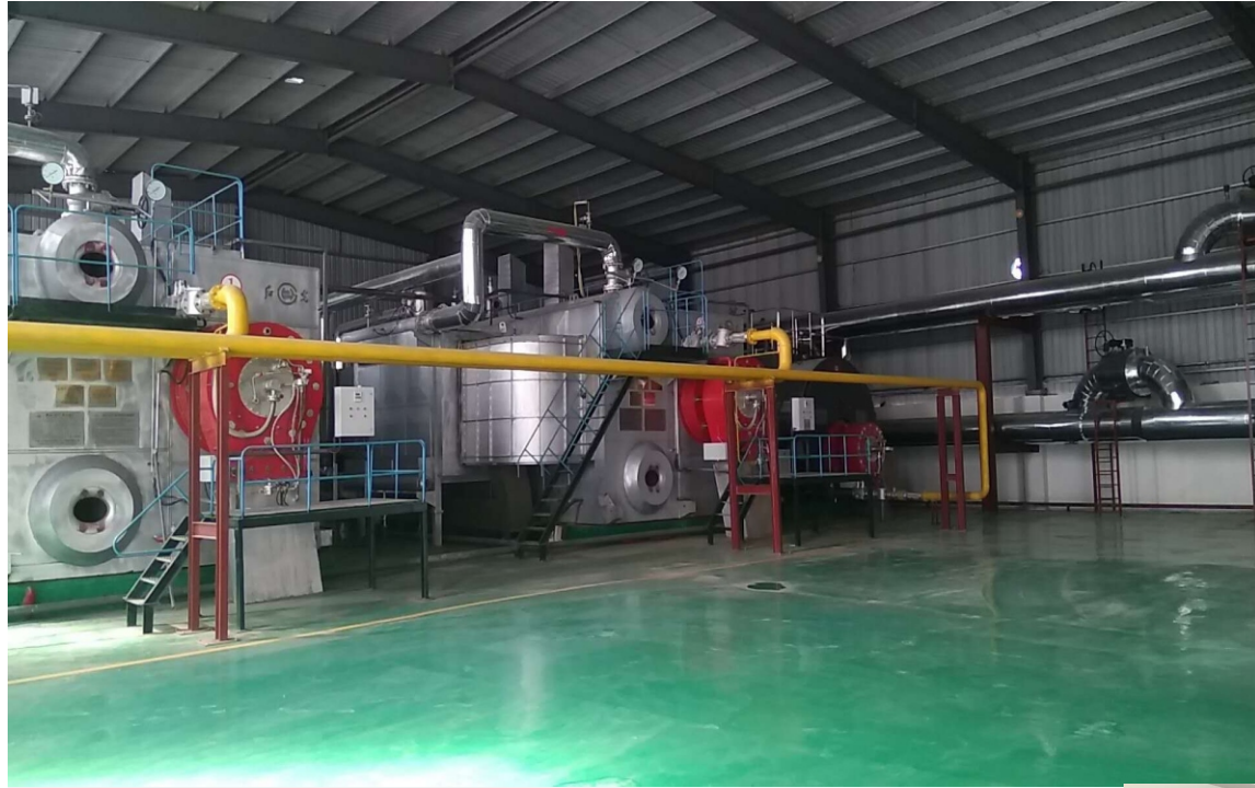
▲ 山东济宁汶上四和热力 两台40吨和1台20吨低氮燃烧器项目
