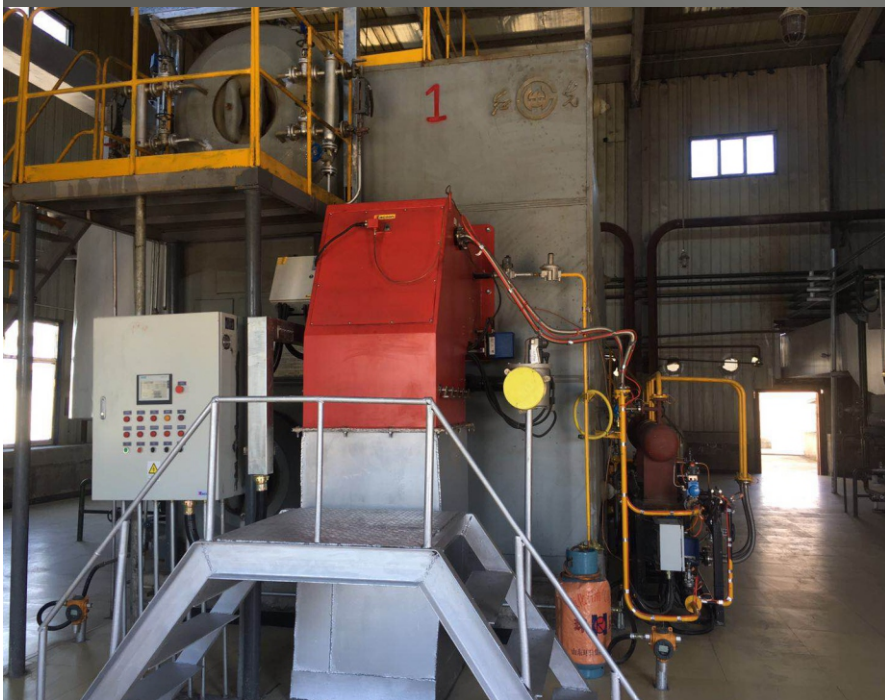
◀ 新疆天之泽化工一期 两台超低氮20吨重油/天然气两用燃烧器项目
