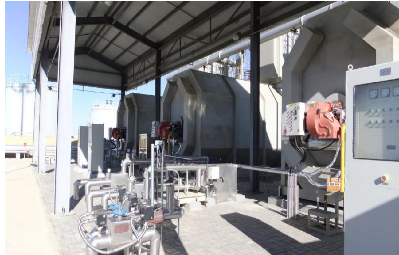
◀ 中石油长呼线五站 12台7MW重油/天然气燃烧器
