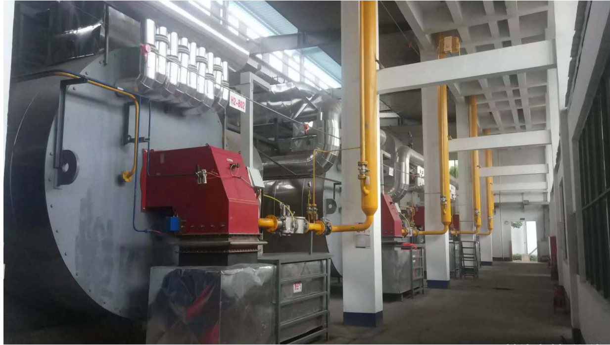
▲ 安徽安利材料科技股份有限公司 7台20吨热风型超低氮燃烧器项目
