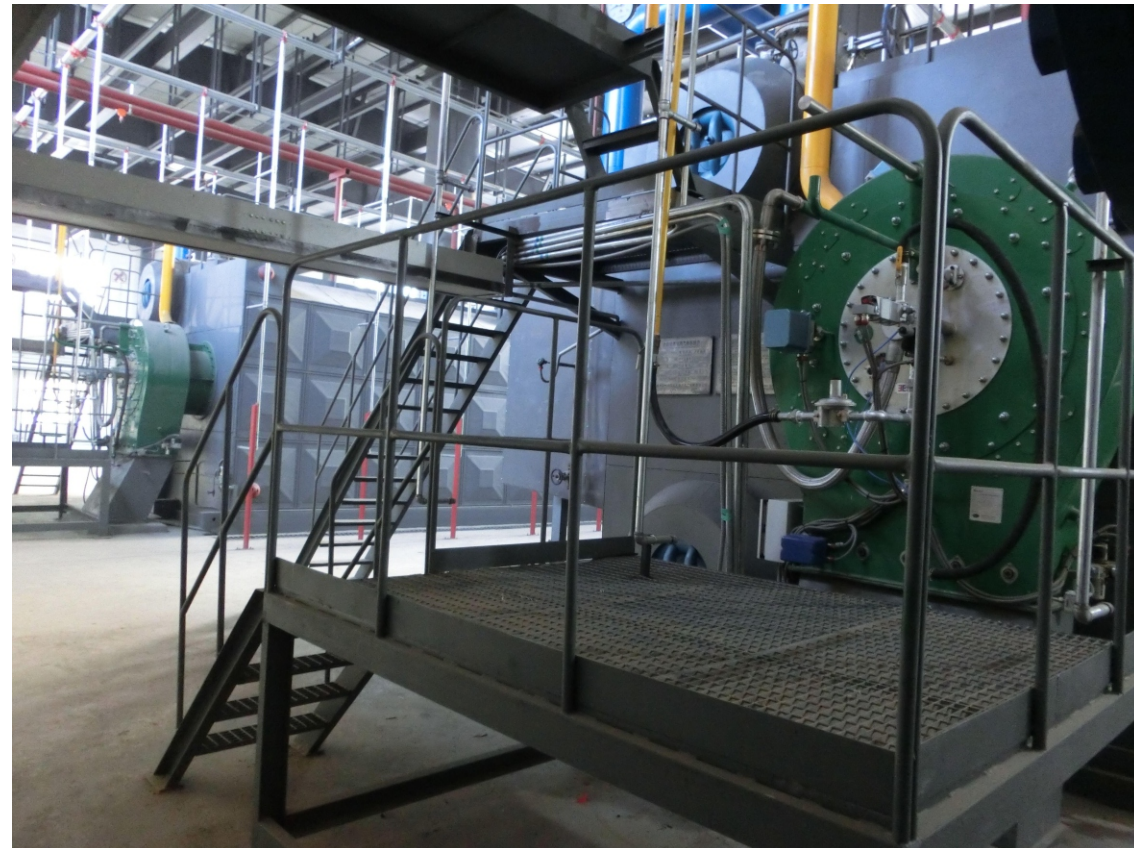
◀ 新疆阿克苏阳光热力有限公司 两台40吨超低氮燃烧器项目
