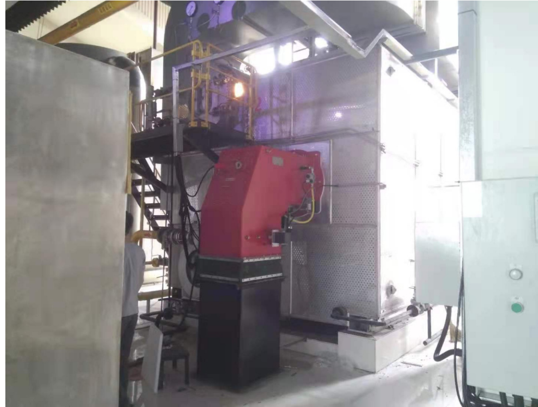
◀ 热力三处（中油管道机械制造有限责任公司） 两台20吨超低氮燃烧器项目
