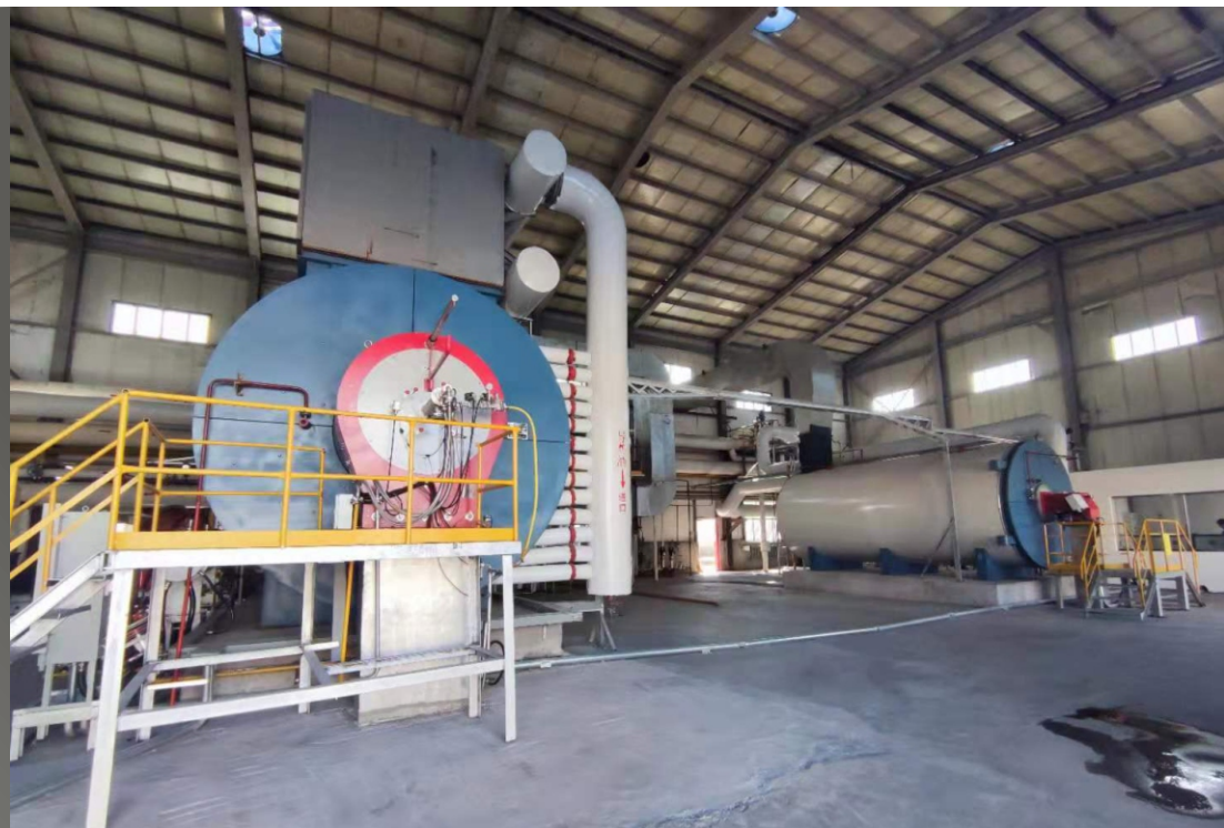
▲ 新疆天之泽化工二期 1台35吨+1台6吨重油/天然气两用燃烧器项目
