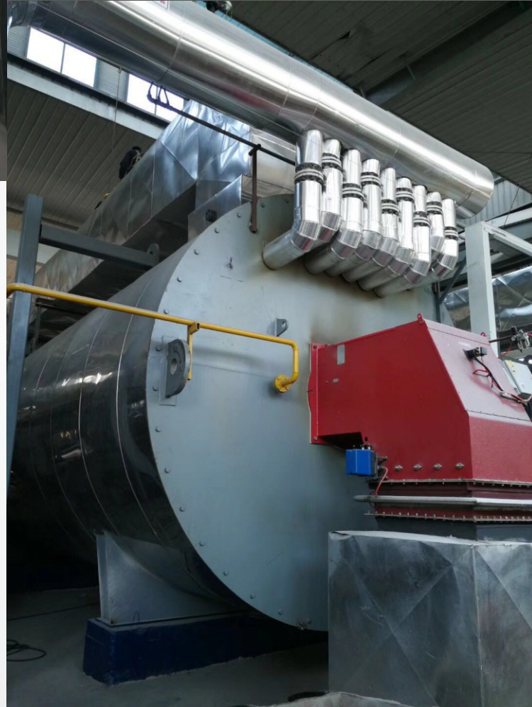
合肥安利皮革有限公司 ▶ 20吨热风型超低氮燃烧器项目
